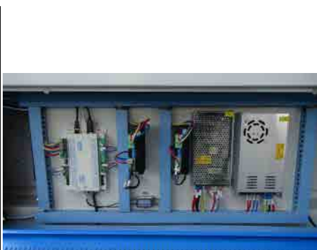
Box de Control
